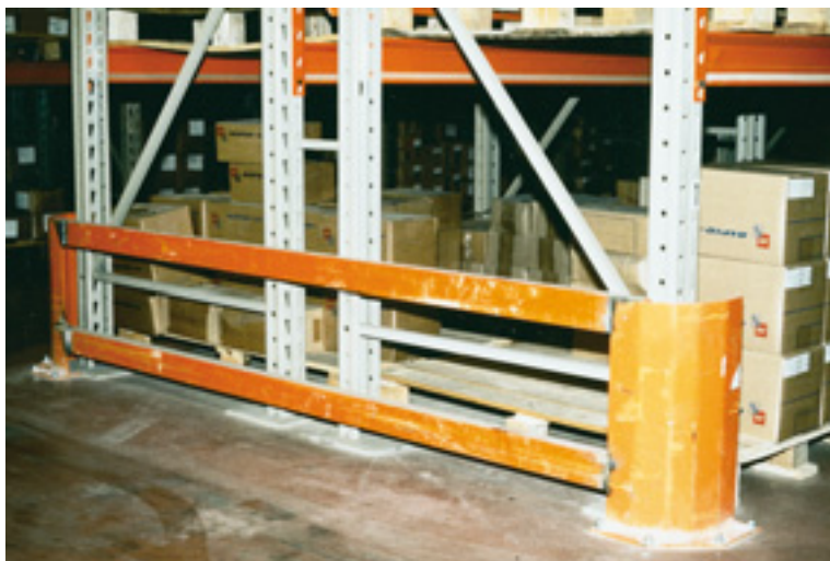
Protection des pieds d'échelle d'extrémité.
