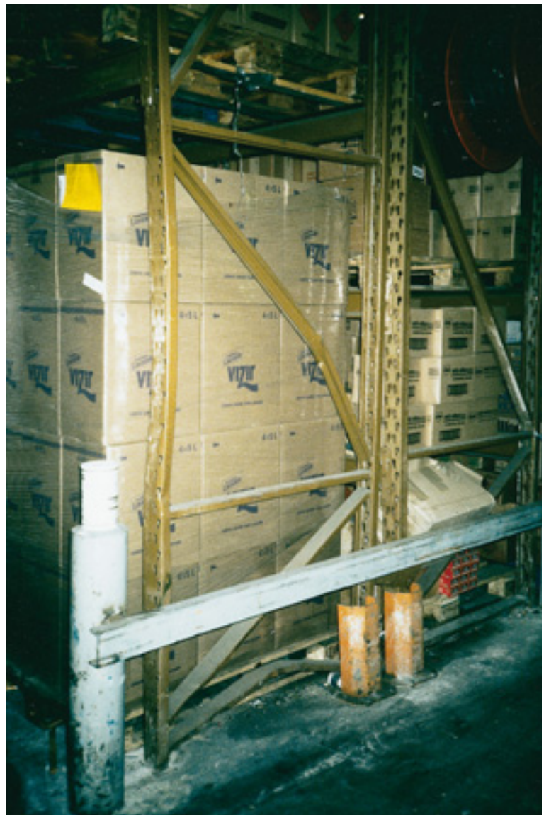
Structure détériorée : à remplacer.
