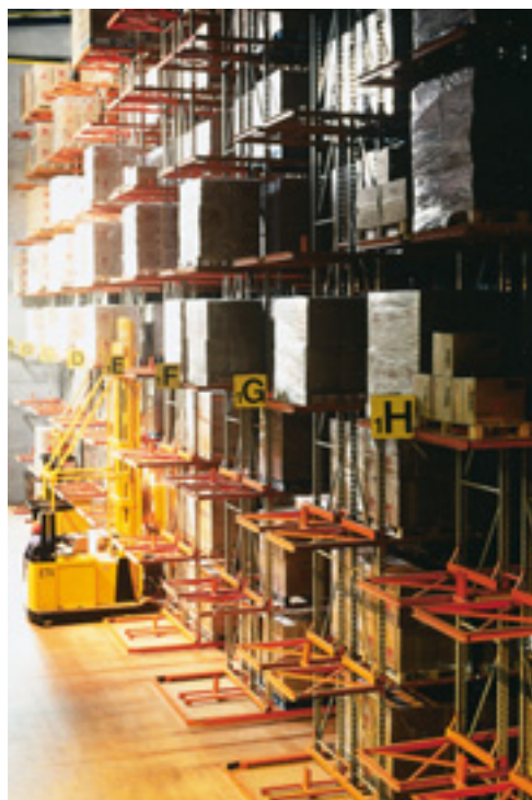
Installation de stockage à grande hauteur.
